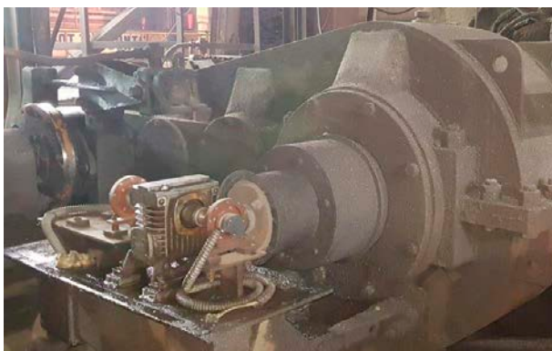
Vorher: Mechanisches Kopierwerk und Absolutwert-Drehgeber angebaut mit einem zusätzlichen Verteilergetriebe.
