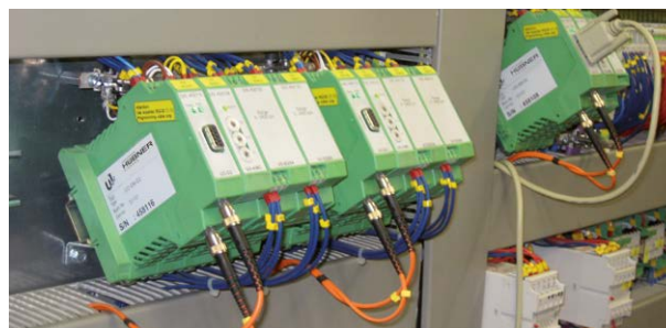
制御盤に設置された電子機能モジュール Electronic function modules installed in switchboard
