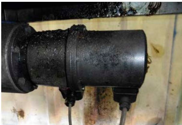
Vorher: Tachogenerator mit angebautem mechanischem Fliehkraftschalter für die Drehzahlmessung und -überwachung am Hubwerk eines RMG-Krans.
