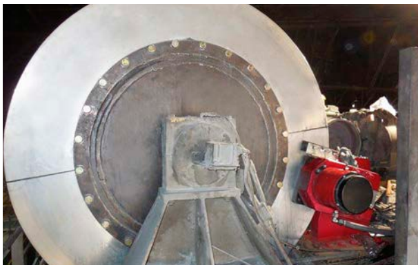
Vorher: Hubwerkstrommel mit mechanischem Kopierwerk, aber ohne Überdrehzahl-Erkennung. Unten rechts im Bild die neue Haltebremse.
