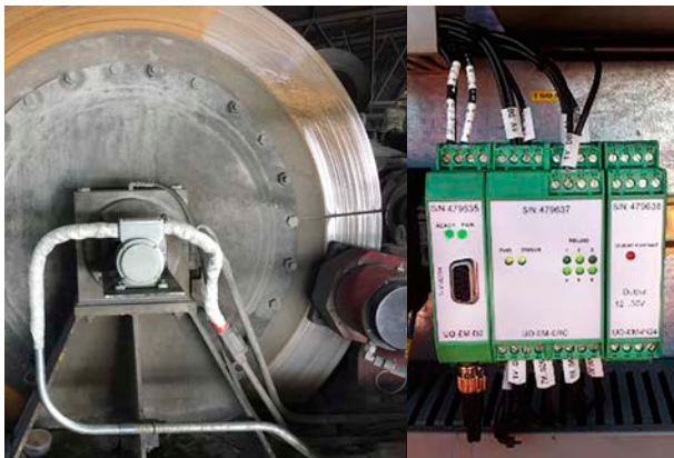
Nachher: Hubwerkstrommel mit U-ONE-Basisgerät und Haltebremse. Der Bildausschnitt rechts zeigt die U-ONE-Elektronikmodule im Schaltschrank.
