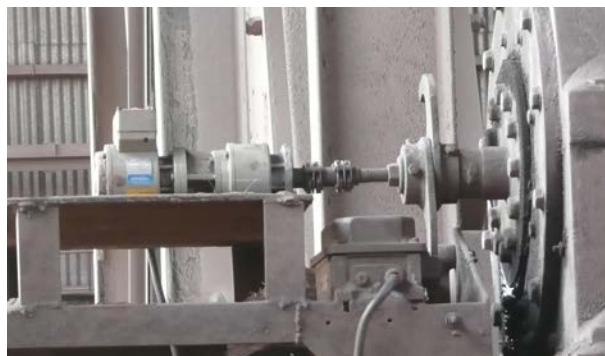
マテハン / 回転式カーダンパ : アブソリュートエンコーダAMN (DeviceNetインターフェース) が取り付けられた軸受ブロック Material handling / Wagon tippler : bearing block with attached absolute encoder AMN (DeviceNet interface)
