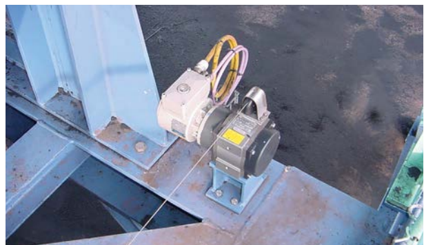
Tratamiento de material / cinta transportadora: transmisor por cable con encoder absoluto AMP acoplado (interfaz PROFIBUS) Material handling / Conveyor belt: rope length transmitter with attached absolute encoder AMP (PROFIBUS interface)
