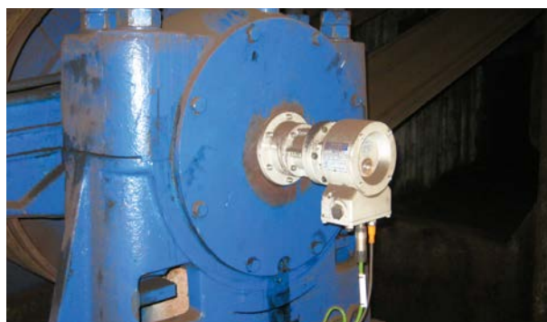
Empresa de suministro de energía / prensa de briquetas: encoder absoluto ASPN (interfaz PROFINET IO) Energy supply company / Briquetting press: absolute encoder ASPN (interface PROFINET IO)
