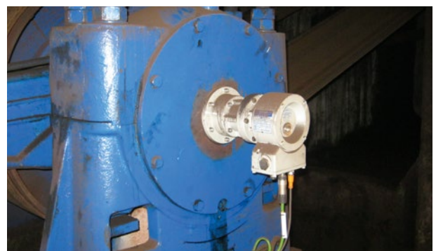
Energieversorgungsunternehmen / Briquettpresse: Absolutwert-Drehgeber ASPN (Schnittstelle PROFINET IO)
