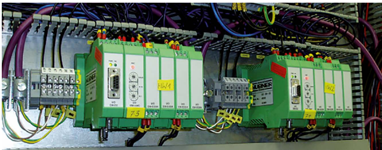
Módulos de funciones en la sala de control/ Function modules in a switchboard
