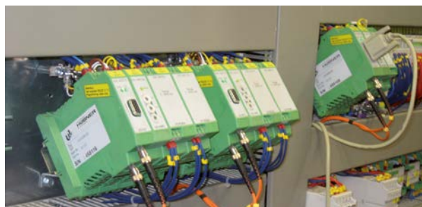
Электронные функциональные модули, установленные в шкафу управления / Elektronic funktion modules installed in switchboard
