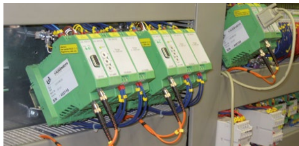
Módulos de função instalados no painel elétrico Elektronik funktion modules installed in switchboard
