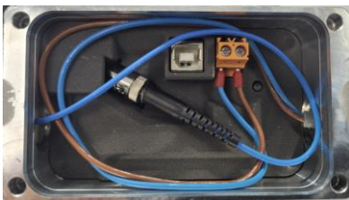
Abbildung: LWL-Kabel und Versorgungskabel im Klemmkasten des FG 40
