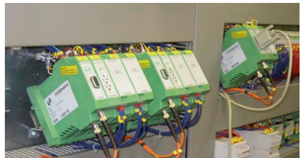
Elektronische Funktionsmodule installiert im Schaltschrank Electronic function modules installed in switchboard
