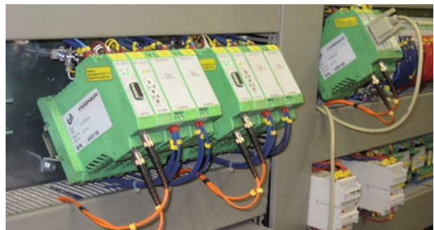
安装在电控柜内的电子功能模块 Elektronik funktion modules installed in switchboard
