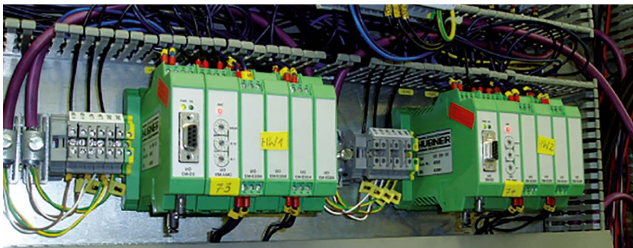
Функциональные модули в шкафу управления / Function modules in a switchboard
