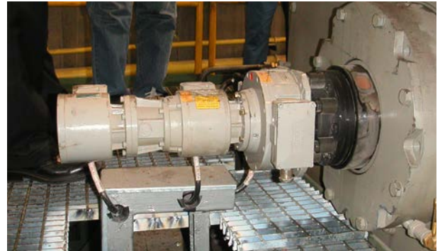
热轧 / 主传动: 空心轴增量编码器 FGH6, 电子超速开关 EGS40 和绝对值编码器 AMS (SSI 接口) Hot rolling mill / Main drive: hollow shaft incremental encoder FGH 6, electronic overspeed switch EGS 40 and absolute encoder AMS (SSI interface)
