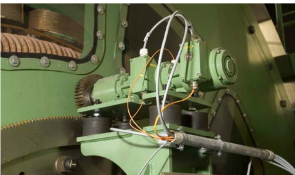
采矿 / 提升机: 轴承座连接有 冗余增量编码器 FG 40 KK 和绝对编码器 AMN L (带 FOC 连接的 DeviceNet 接口)
